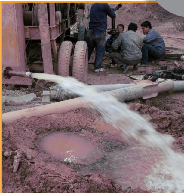
深井水源出水（陕西省千阳县项目办提供）
